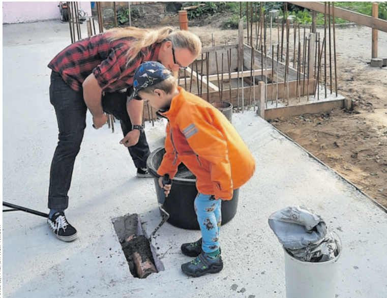
Jonathan Gunkel, 5 Jahre, und Robert Gutsche, seit 1. August Gemeindepädagoge in Dierkow, mauern eine Kapsel mit Zeitdokumenten in das Fundament des Anbaus am Slüterhaus in Dierkow ein.
