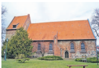
Die Dorfkirche von Koserow kann nur noch mit einer Stützkonstruktion offen gehalten werden. Ihre Sanierung wird rund 350 000 Euro kosten.
