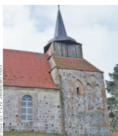
Der Turm der Zirchow Kirche muss saniert werden.
