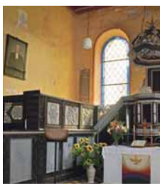
Die Wandfarbe blättert ab, der Dachstuhl ist undicht.
