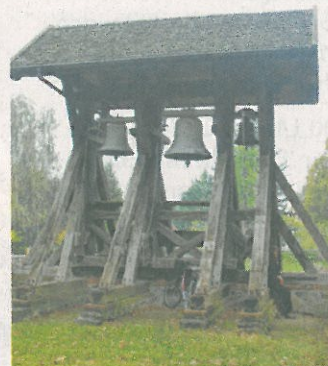
Der Alt Metelner Glockenstuhl muss saniert werden.
