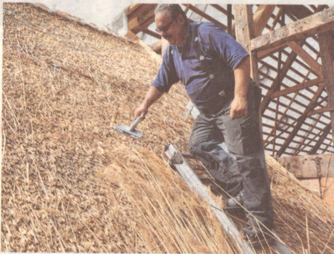
Dachdeckermeister Thorsten Ring nutzt eine kleine Regenpause und arbeitet an der Cramoner Pfarrscheune weiter. Insgesamt werden dort mehr als 17 Tonnen Reet verbaut. FOTO: HANS TAKEN
