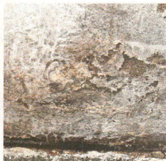
Putz und Farbe an den Innenwänden der Kirche platzen ab, Schimmel breitet sich aus.
