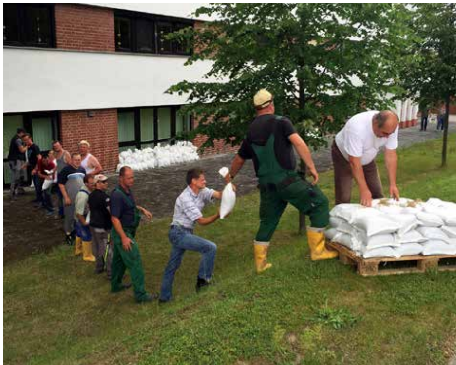
Da unmittelbar nach der Sturzflut erneute Regenfälle erwartet wurden, sicherten Mitarbeitende und Freiwillige das Untergeschoss mit Sandsäcken. Foto: Kai Becker
