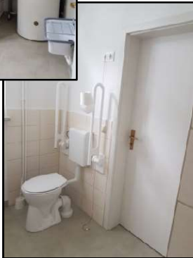
Behindertengerechtes WC mit Rufanlage
