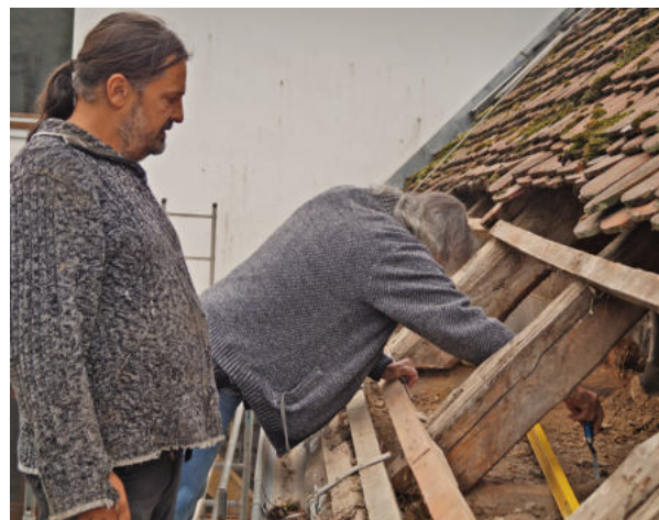
Foto, oben links: Kirche Weisin, JB Foto, oben rechts: Pfarrhaus Benthen, JB Foto, unten Mitte: Bernhard Zimmermann und Jörg Baschista bei der Untersuchung der Deckenbalken, RF
