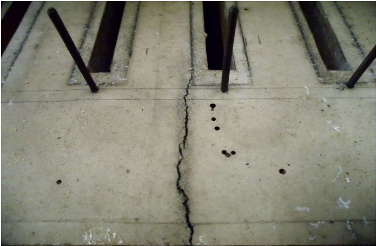
Risse in der Windlade
