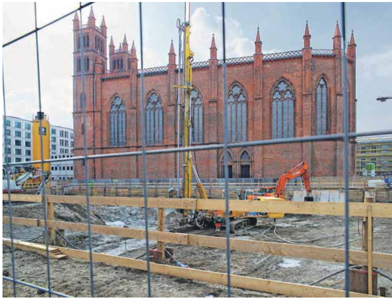
Baustelle vor der Friedrichswerderschen Kirche in Berlin 2016 – ein Bild für den Wandel einer Institution.
