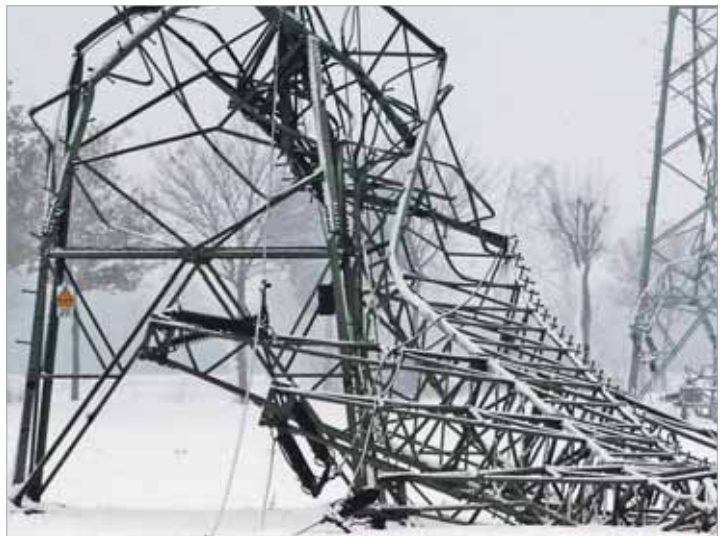
Nichts ging mehr: Ende November 2005 knickte eine ungünstige Schnee-Wetterlage im gesamten Westen Deutschlands zahlreiche Strommasten um und sorgte für einen mehrtägigen Stromausfall. Foto: WDR/LWL
