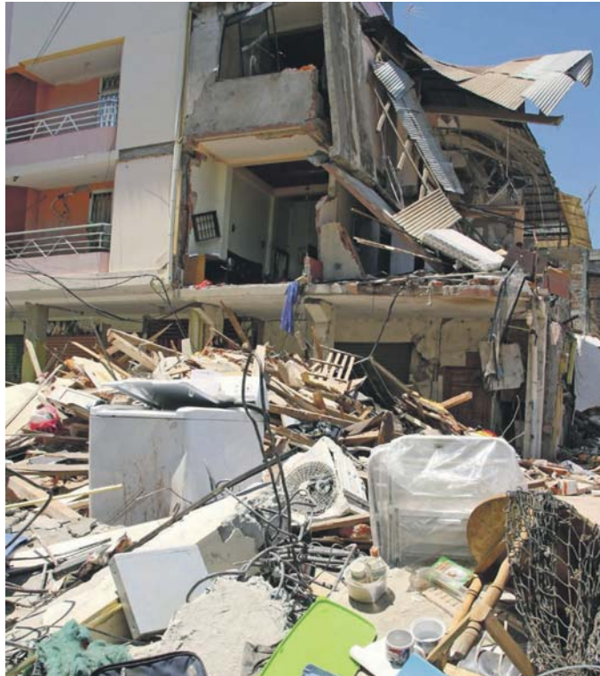
Bilder des Schreckens gehen täglich um die Welt. Ein Erdbeben zerstörte im April 2016 dieses Wohnhaus in der Küstenregion Ecuadors. Zehntausende Menschen wurden obdachlos. Fotos (2): epd
