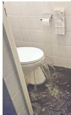
Das Wasser drückte aus der Kanalisation hoch.
