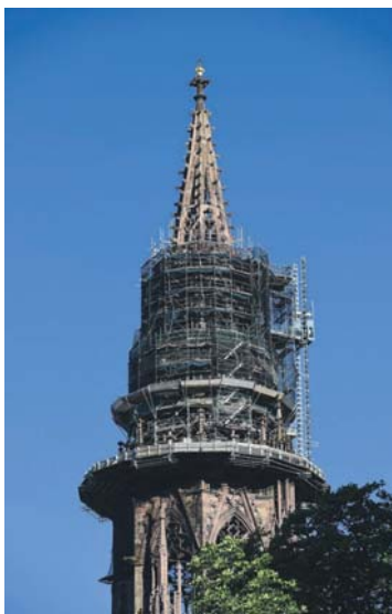
Ab Mitte Juli werden die Gerüste am Turm abgebaut. 2005 hatten die Sanierungsarbeiten begonnen, weil seine Stabilität bedroht war. Immerhin konnten drastische Maßnahmen verhindert werden. Foto: KNA
