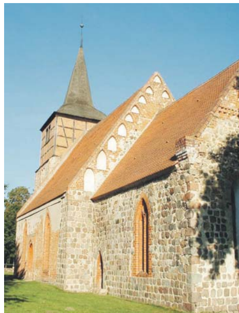
Die Kirche in Sietow in Müritznähe muss saniert werden.
