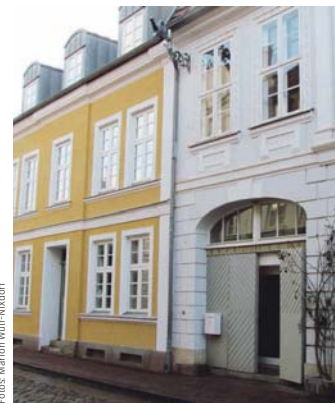
In dem 2009/10 vollständig sanierten „neuen“ Haus (li.) wurde 2012 Schwamm entdeckt.
