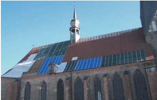
Von einem Tornado wurde Bützow am 5. Mai heimgesucht. Auch die sanierte Stiftskirche aus dem 13. Jahrhundert wurde stark beschädigt.
