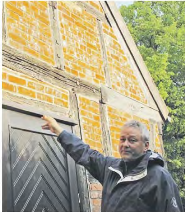
Harald Perleberg weist auf die maroden Fachwerk-Balken der Neuendorfer Kapelle. Für die Notsicherung will der Förderverein bis zum Spätsommer 5000 Euro sammeln.
