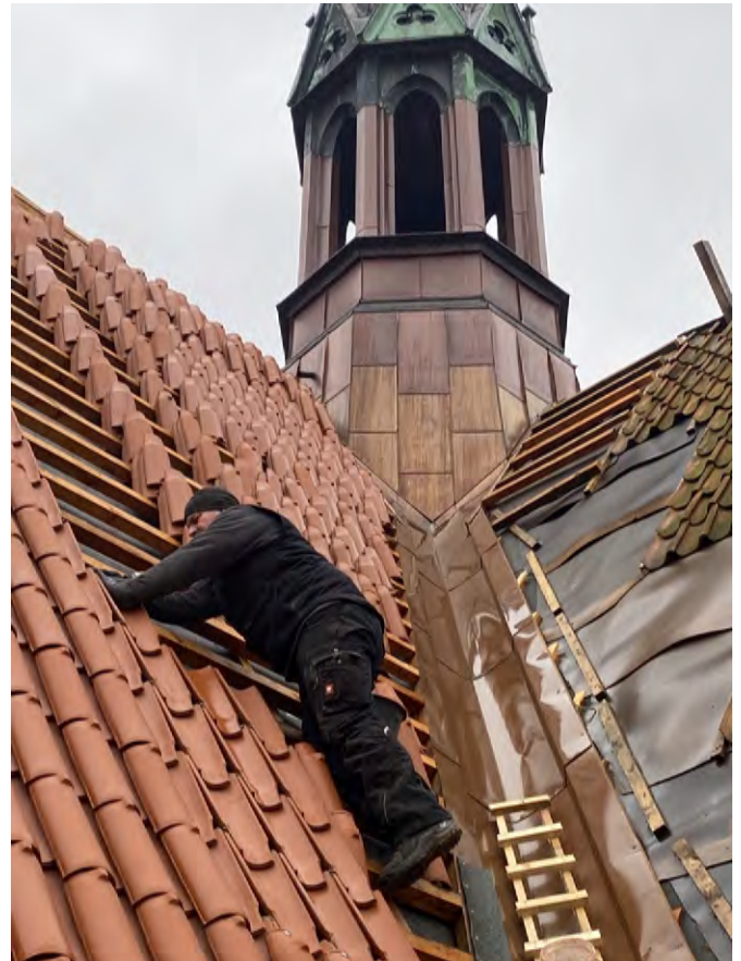
Wie hier in Neukloster sind es oft Dachschäden, die beseitigt werden müssen. Foto: C. Meyer
