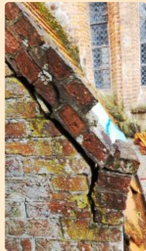
Risse im Giebelmauerwerk
